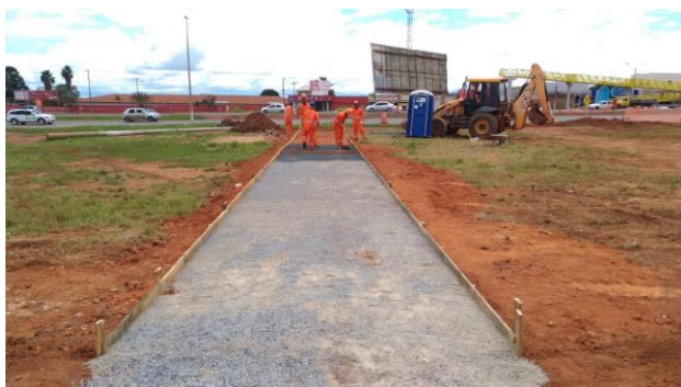
Foto 05: Calçada lado Norte
