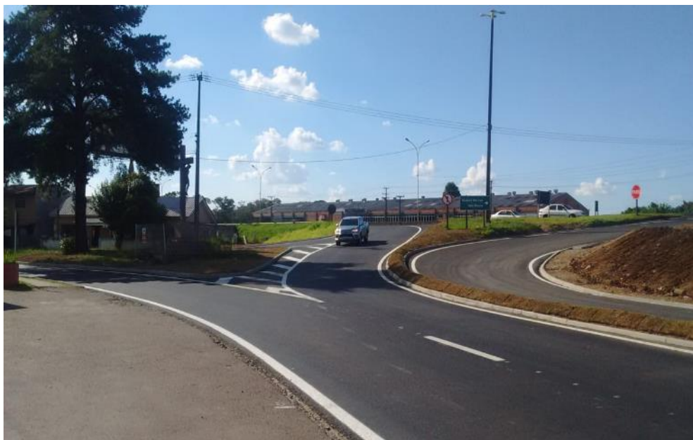
Figura 4 –Pavimento– Disp. Km 17+530.
