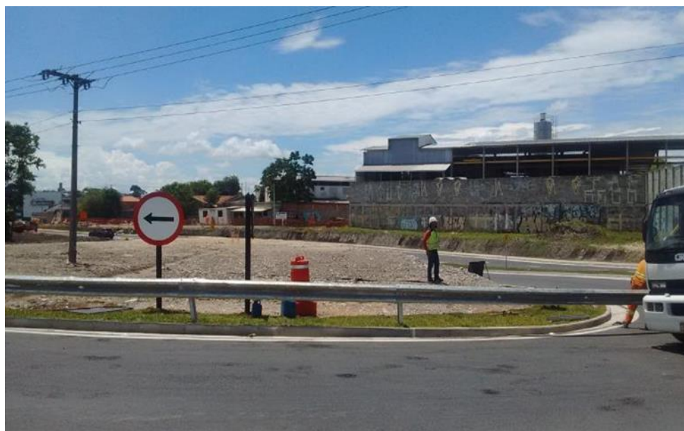
Figura 9 – Elemento de Segurança – Disp. Km 17+530
