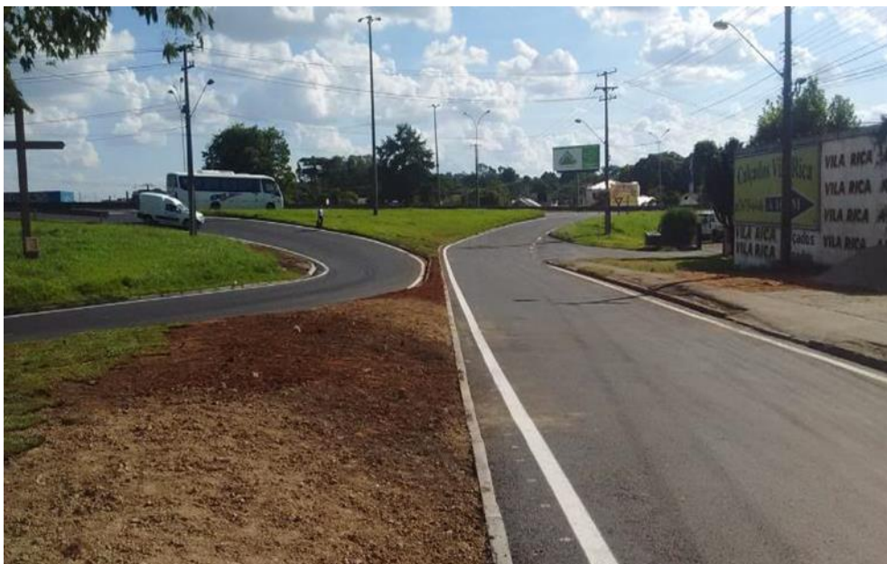
Figura 6 – Pavimento – Disp. Km 17+530
