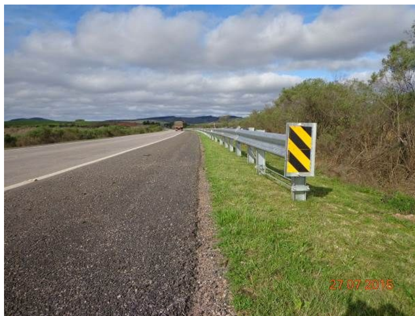
Figura 07 – Defensas metálicas – BR-392/RS
