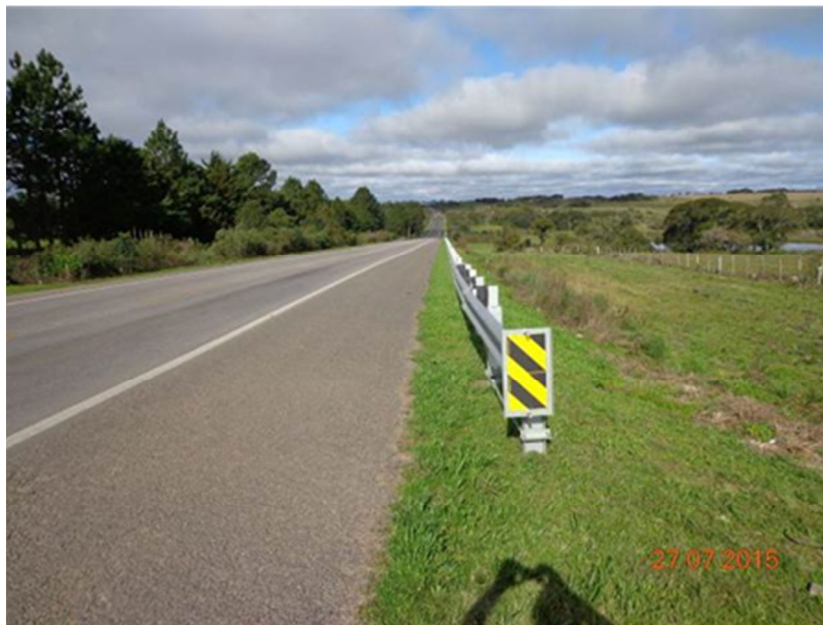
Figura 06 – Defensas Metálicas – BR-392/RS
