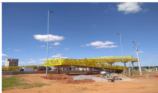
Foto 01: Serviços elétricos e SPDA
