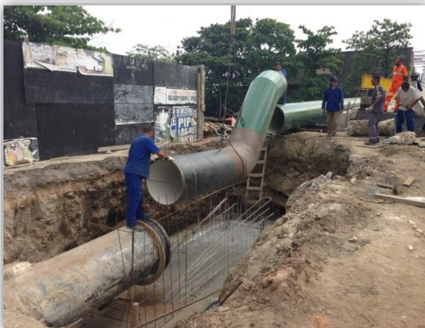
Figura 04 – Remanejamento de adutora
