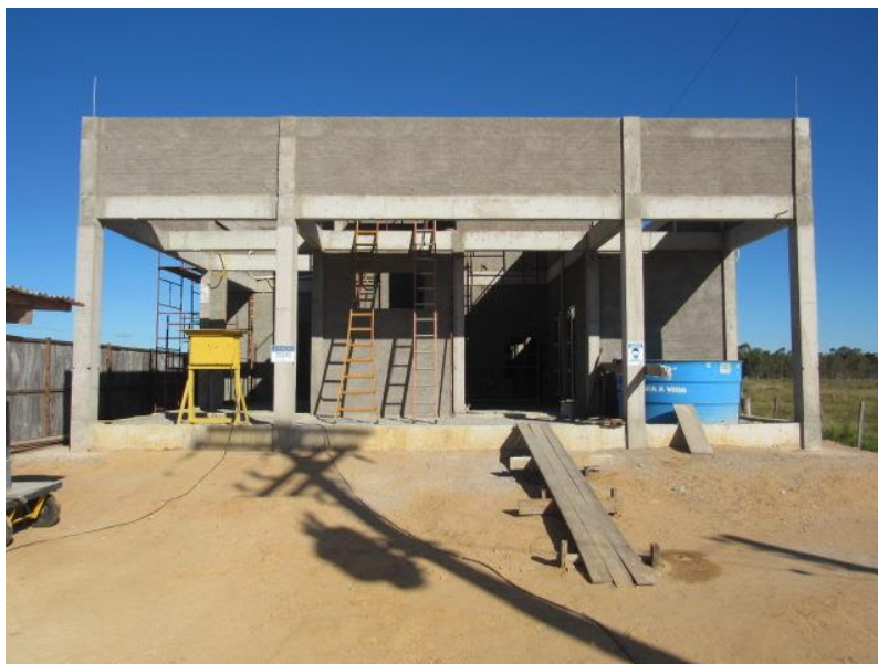
Figura 04 – Conclusão do preparo para recebimento do emboço e reboco na alvenaria – Base Operacional - BR-392/RS – Trecho: Pelotas – Rio Grande / km 033,059
