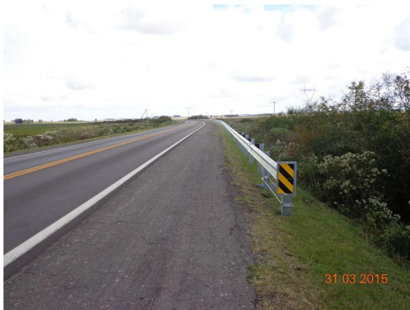
Figura 04 – Defensas metálicas – BR-116/RS
