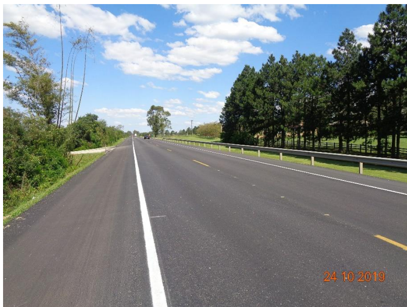
Figura 02 – Serviços de recuperação do pavimento BR-392/RS – Trecho Pelotas – Santana da Boa Vista / km 076+000
