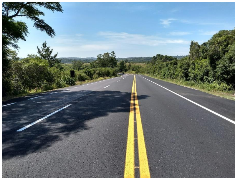
Figura 02 – Serviços de recuperação do pavimento BR-392/RS – Trecho Pelotas – Santana da Boa Vista / km 097+500
