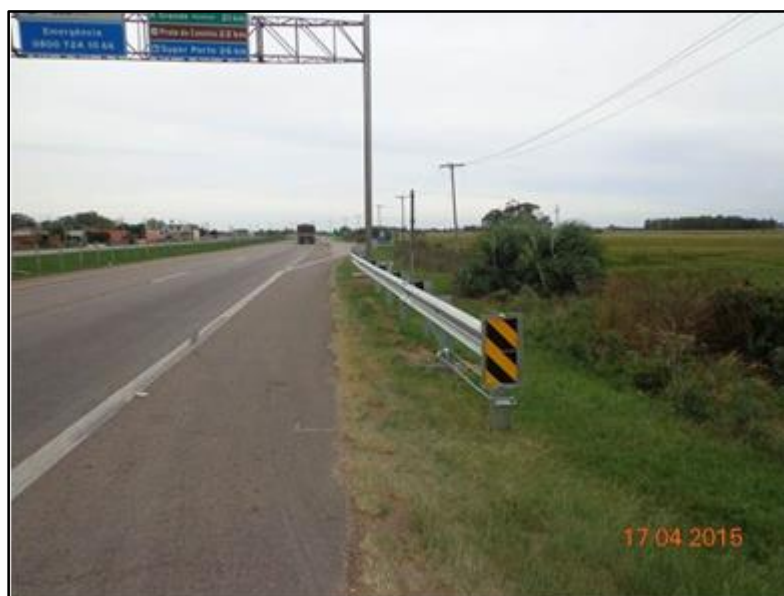
Figura 07 – Defensas metálicas – BR-392/RS
